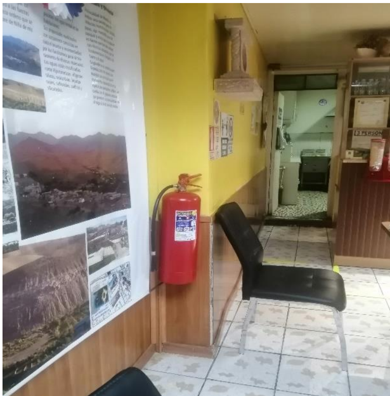
Foto de extintor en área de comedor 1.er piso
