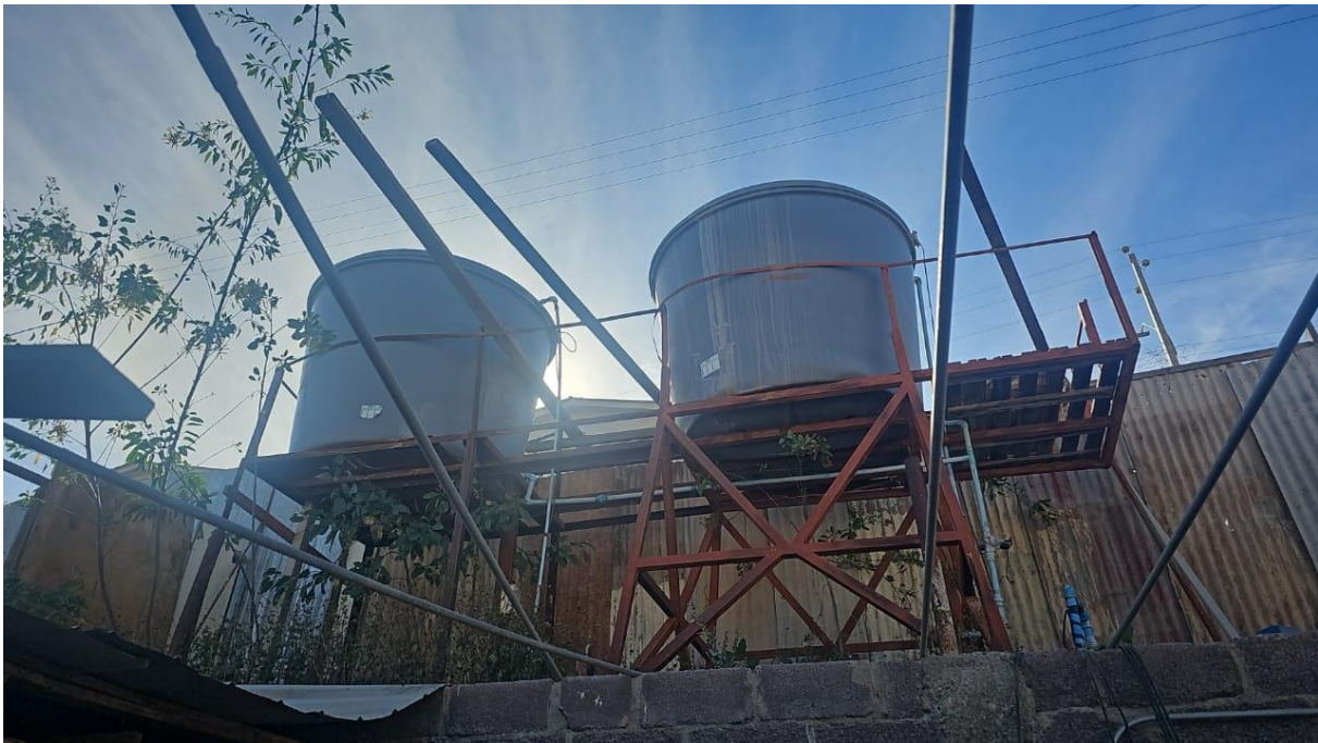
Foto estanques de agua con sistema hidroneumático
