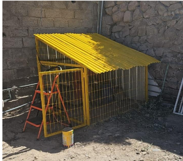
Foto Generador de Energía 1.er piso estacionamiento
