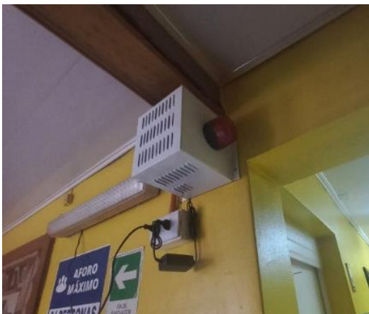
Foto sistema alarma 1.er piso comedor
