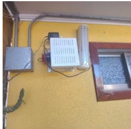
Foto sistema alarma 2.do piso patio
